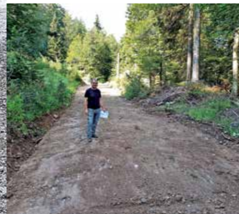
Unzureichende Wasserhaltung führte zur Ausschwemmung der Fahrbahn.
